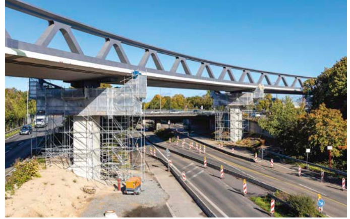
Düsseldorf: Die Stadtbahnbrücke für die U81 über den Nordstern ist in Bau. Führt die Linie künftig bis Ratingen? MICHAEL BEITELSMANN (2)
