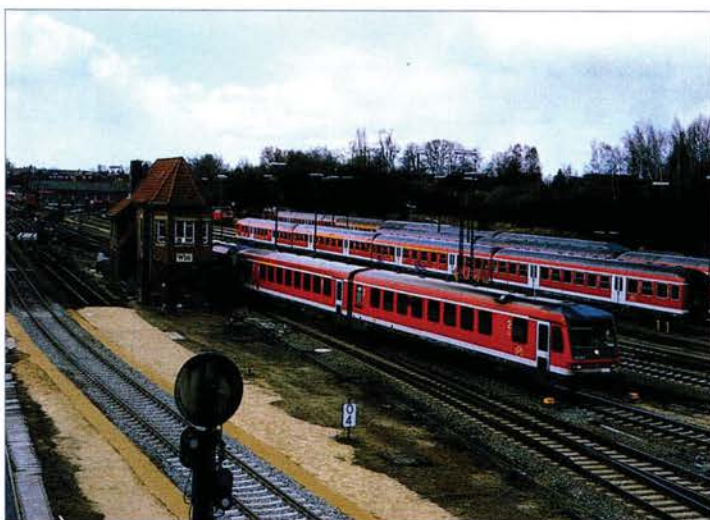
■ Der Umbau des Lübecker Hauptbahnhof hat bereits begonnen. Die Formsignale werden durch Lichtsignale ersetzt. Die alten Stellwerke werden durch ein ESTW ersetzt. Der Umbau steht im Zusammenhang mit der Elektrifizierung der Strecke von Hamburg nach Lübeck.
