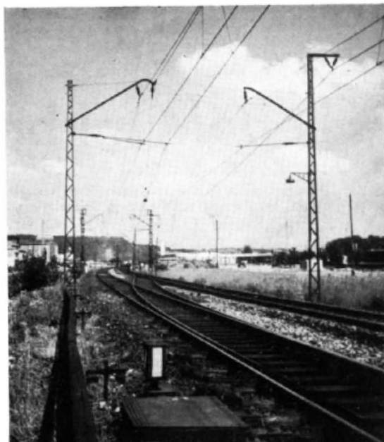
Abb. 9. Mast mit zweitem Seitenhalter bei einer Situation nach Abb. 7 C beim Vorbild.
