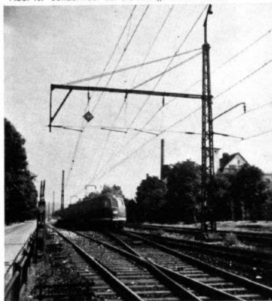
Abb. 10. Sondermast der DB infolge Straßennähe.
