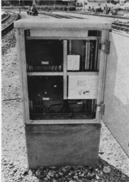
Abb. 6. Der Modulator-Schrank zwischen den Gleisen; dies ist der eigentliche „Fernsehsender“.
