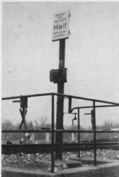
Abb. 4. Muß auf einer mit Blinklicht-Warnanlagen ausgestatteten Strecke rangiert werden, so setzt man die Automatik vorher außer Betrieb. Die Rangiergruppe hält vor jedem Bahnübergang, wo der Rangierer die Blinklichtanlage einschaltet. Der Schaltkasten ist am Rohr der Halt-Tafel angebracht.
