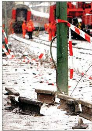
Das Corpus delicti: Der zerstörte Gleisabschnitt wird nun intensiv untersucht.
