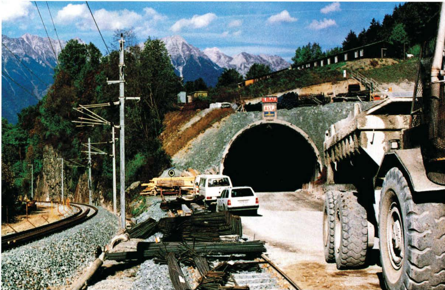
Eine Vorleistung für den geplanten Brenner-Basis-Tunnel ist der Bau des 12 km langen Inntaltunnels in Österreich – hier das Südportal.
