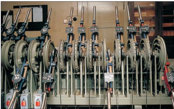
Die Hebelbank des Fahrdienstleiterstellwerks „Mwf“: Hinter der Hebelbank der Verschlusskasten, der die mechanische Abhängigkeit zwischen Weichen und Signalen herstellt. Die Hebelbank umfasst sämtliche Hebel für die Weichen, Riegel und Signale.
