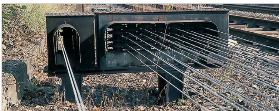
Druckrollen für die zahlreichen Drahtzugleitungen im östlichen Bahnhofsbereich: Auf dem Querträger unterhalb der Seilrollen sind auch Gleissperrsignale („Hs“) aufgeführt. Die einzelne Druckrolle links im Bild führt die Doppelleitung zu einem Gleissperrsignal, wo sie oberirdisch mit dem Signalantrieb verbunden wurde.
