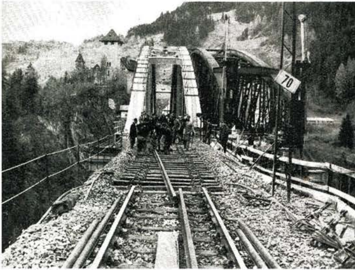
Bild 3 Gegen 11.00 Uhr vormittags des 16. November 1964 wurde das neue Gleisstück über die Brücke verlegt und angeschlossen.
