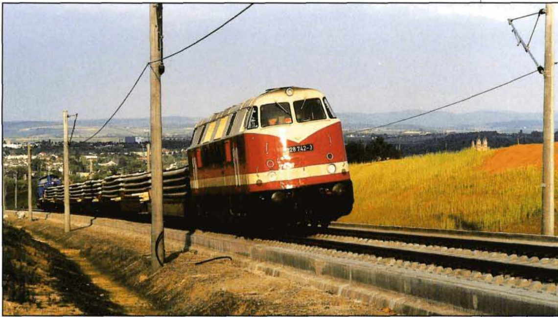
Bild 4: Am Elzer Berg müht sich die EBM-228 742 mit einem Betonschwellenzug ab, unterstützt durch die schiebende MWB-V 1351.
