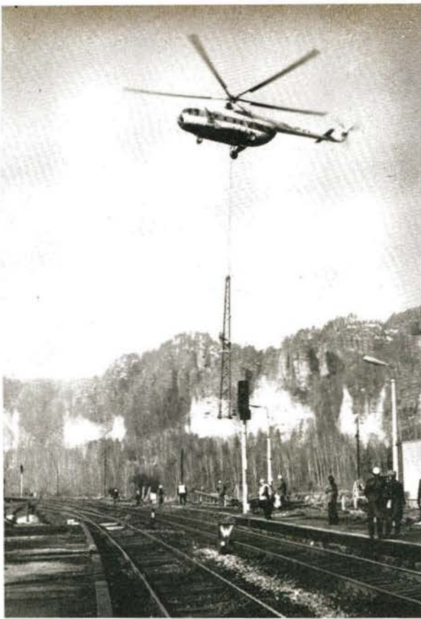
Bild 3 Aufstellen von Fahrleitungsmasten mit Hilfe von Hubschraubern der Interflug im Bf Kurort Rathen
