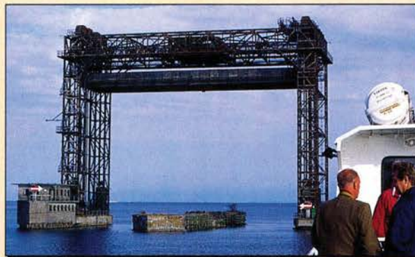
Fast 60 Jahre später erinnern nur noch die Reste der Hubbrücke an die Strecke von Ducherow nach Swinemünde.
