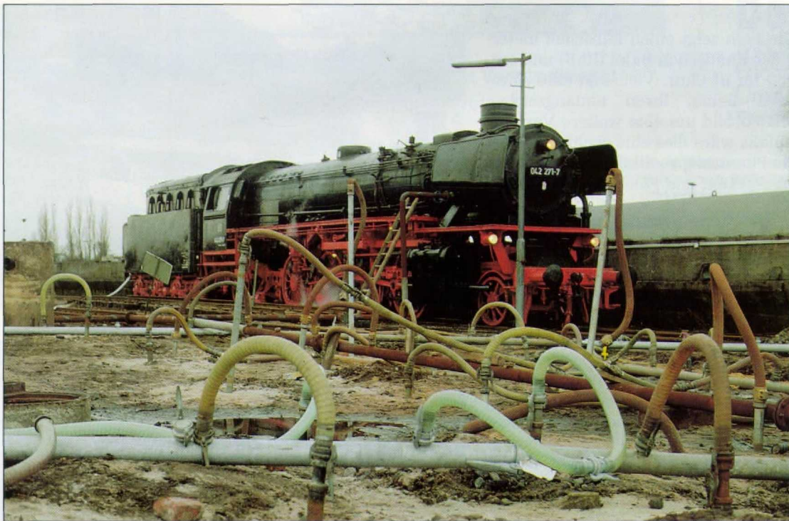
Die Heizlok in Neumünster, davor das Gelände der ehem. Dieseltankstelle. Über die Rohre wird der von der Lok erzeugte Dampf in die Erde gedrückt. Foto: Peter Tadsen.
