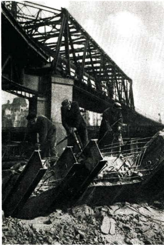
Bild 1 Zerstörte Brücken und Bahnanlagen — das Erbe einer Zeit, in der die „Räder für den Sieg rollten“
