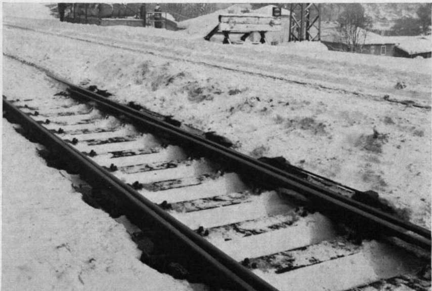
Abb. 1. Besser und eindringlicher läßt sich die Wirkung der Weichenheiz-Anlagen kaum demonstrieren: trotz der dichten Schneedecke sind die beweglichen Weichenteile frei. Im Bildhintergrund eine Anzahl von Gasbehältern. (Werkfoto: Pintsch-Bamag)
