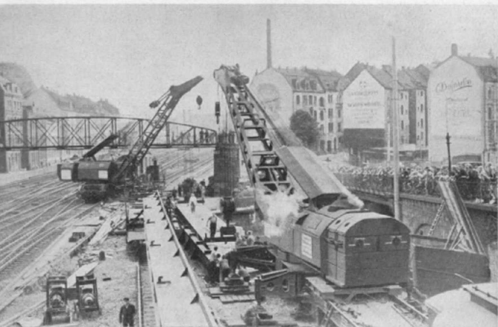
Abb. 1. Ein 90-t-Kran (vorn rechts) und ein 57-t-Kran im Einsatz bei Brückenbauarbeiten. Man beachte beim 90-t-Kran die beiden Gegengewichte und die darunter befindlichen Gewicht-Rollwagen. (Foto Bellingrodt).
