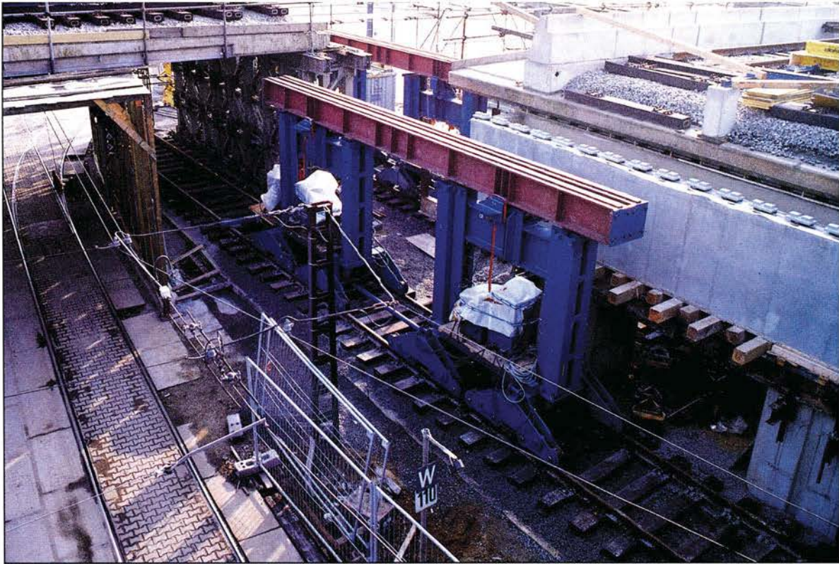
Die Verschiebeinrichtung besteht aus zwei Gleisroller-Komplexen. Jeder dieser Komplexe besteht aus vier zweiachsigen Fahrgestellen und wird autonom gesteuert. Die Parallelität der Bewegung der Komplexe ist Sache der Monteure.
