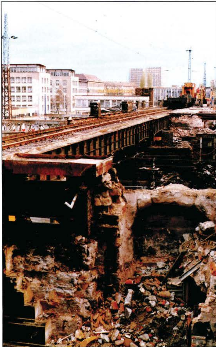
Der Blick auf den Abbruch der alten Widerlager, Zwischenstützen und Überbauten offenbart den maroden Zustand der verbrauchten Bausubstanz.
