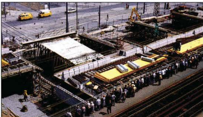
Die (vorläufige) Endlage des Überbaus ist erreicht. Die auf dem vorderen Gleis befindliche Holzabdeckung verlängert den Außenbahnsteig 19 behelfsmäßig.
