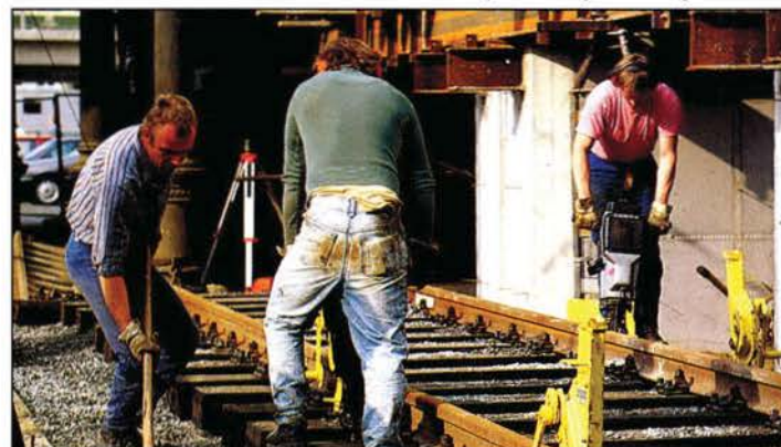
Um die Verschubbahn für die hydraulischen Gleisroller absolut eben zu halten, müssen diese sorgfältig vermessen und gründlich gestopft werden.
