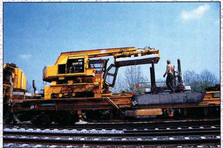
Ein fahrbarer Kran eilt zwischen Verlegeinheit und Schwellentransportwagen hin und her, um das Magazin nachzufüllen. Die Pufferlücken sind durch Klappschiene überbrückt.
