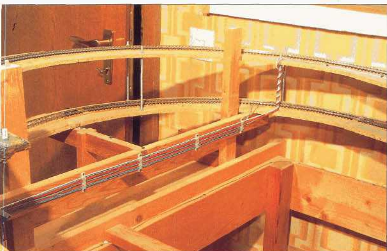
Bild 12: Der linke Anlagenbogen wurde ebenfalls in der Gewindestangen-Bauweise ausgeführt und erhielt spezielle Stützen für das Landschaftsteil.
